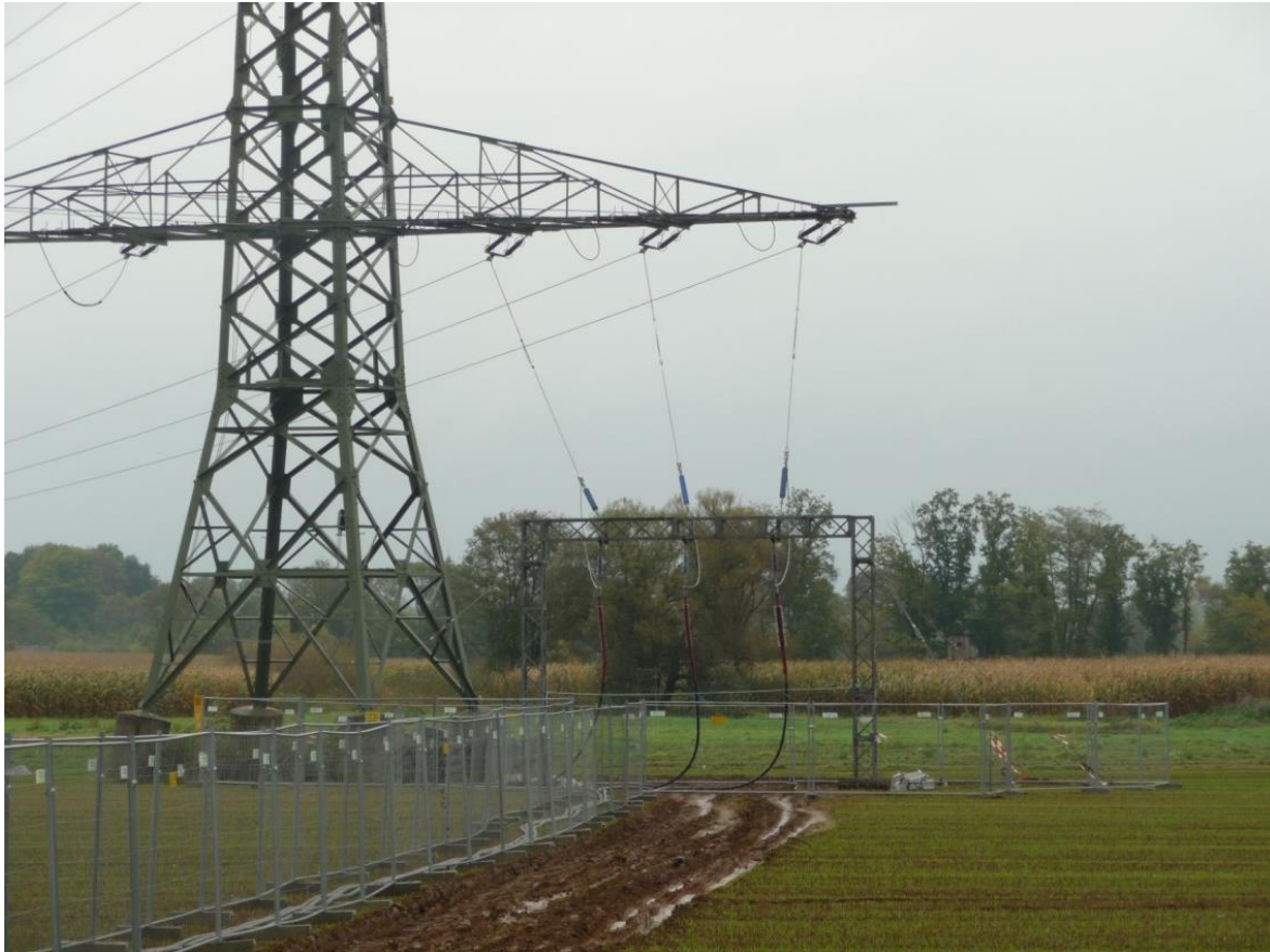
Abbildung 44 15: 110-kV-Kabelprovisorium mit Übergangportal
