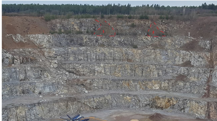
Abbildung 1: Blick vom Steinbruch zur Steinbruchkante an der B 16 mit Rutschungen
