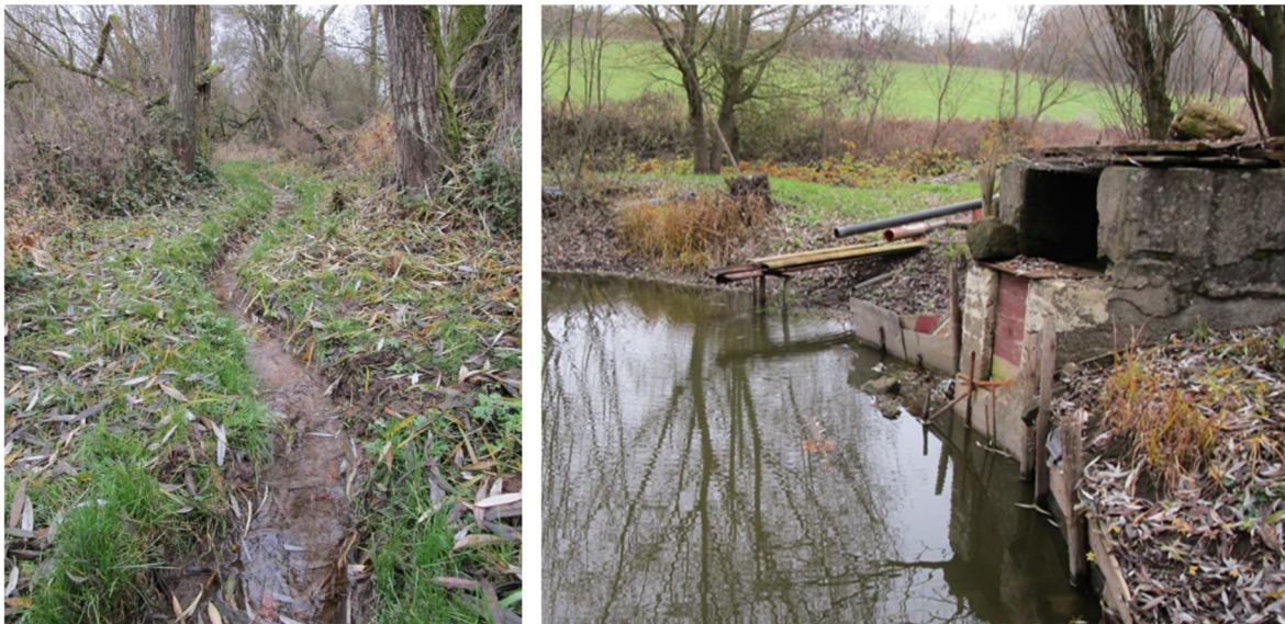
Bild 2 und 3: Trockenwettergerinne und marodes Auslaufbauwerk am Rückhalteteich RHT 260
